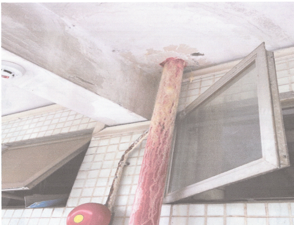
4、个别管道周边渗漏水图片
