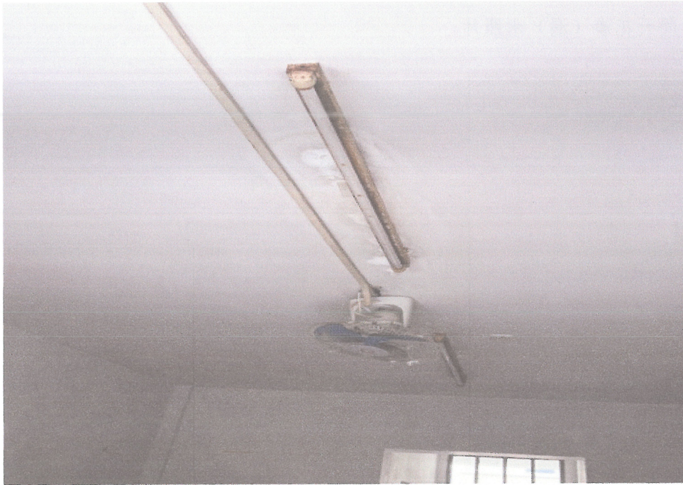
3、中间楼层部分房间，天花中央灯管位置渗水照片
